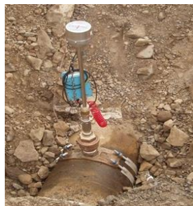
Figure 1. Exemple d'installation en mesure temporaire sur le réseau
