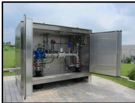
Figure 13. Poste de contrôle de pression hors-sol (Ville de Québec)
